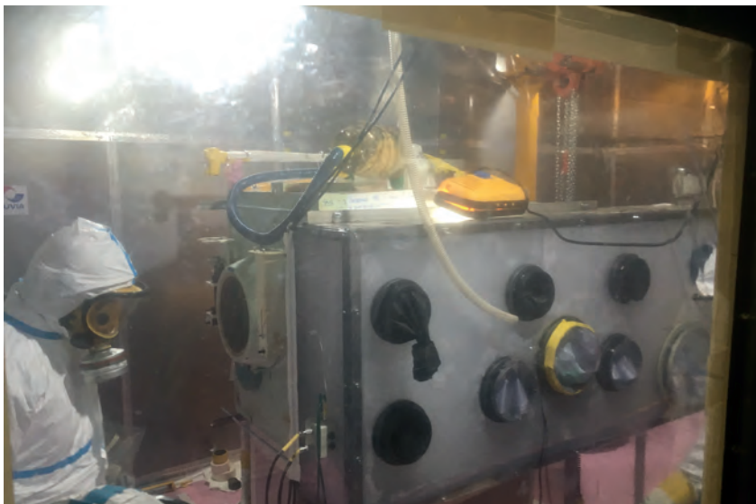
Accostage d'une boîte à gants sur le sas de l'enceinte Castor et Pollux.
